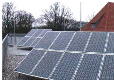
Fig. 5.1.8.6: Instalación captadora aislada para una instalación fotovoltaica.
