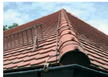
Fig. 5.2.2.1.3: Instalación captadora con conexión al canalón del tejado.
