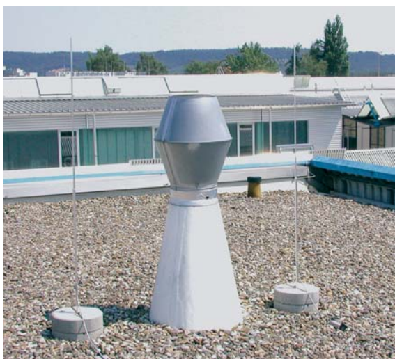
Fig. 5.1.8.2: Instalación captadora aislada. Protección con punta captadora.
