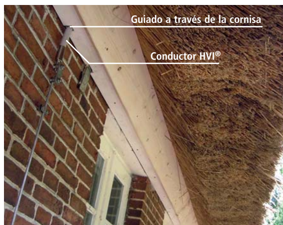
Fig. 5.1.5.7: Conductor HVI guiado por la cornisa.
