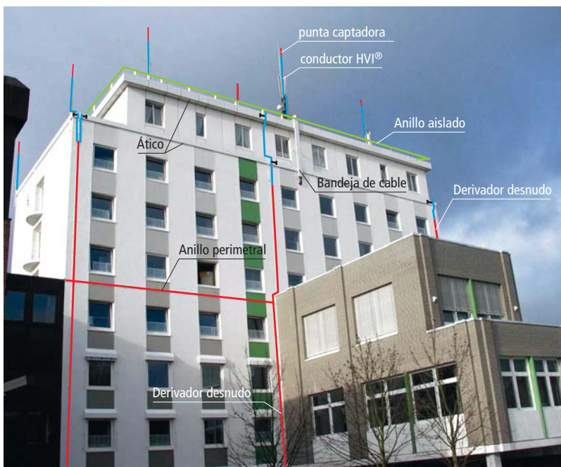
Fig. 5.2.4.3.4: Vista general de la nueva protección externa contra rayos.
