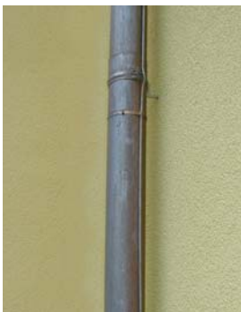
Fig. 5.2.2.2.4: Derivador instalado a lo largo de la tubería.
