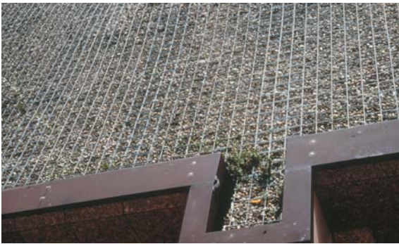
Fig. 7.3.7a: Rejillas de acero galvanizadas.
