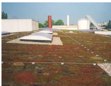
Fig. 5.1.7.2: Instalación captadora sobre un tejado ajardinado.
