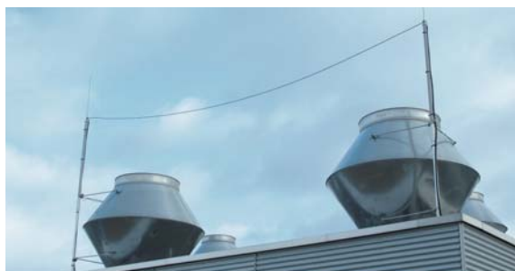
Fig. 5.2.4.2.3a: Ventiladores con puntas captadoras y tendido de cable.
