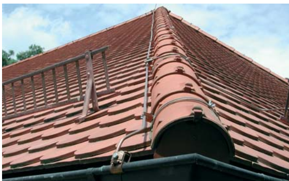
Fig. 5.1.1.18: Tejado a dos aguas con soportes para conductor.
