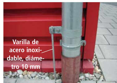
Fig. 5.2.2.1.4: Puesta a tierra de bajantes de agua.
