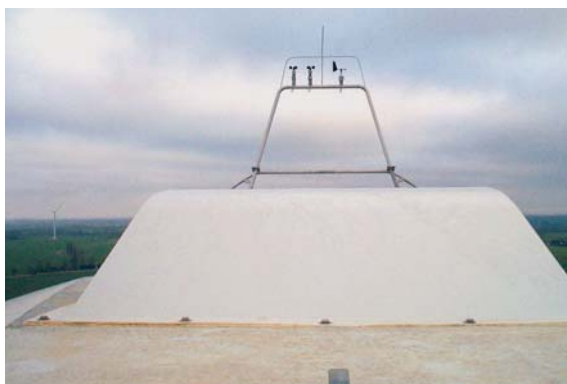
Fig. 5.1.10.2: Protección contra rayos de anemómetros situados en un aerogenerador.
