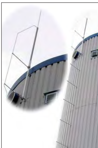
Fig. 9.3.7: Protección del depósito fermentador con planchas de metal con dispositivo captador separado. (Fuente: Büro für Technik, Hösbach).
