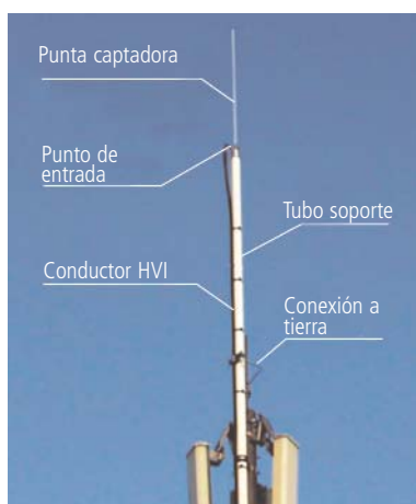
Fig. 5.2.4.2.2a: Tubo aislante en la zona de la antena.
