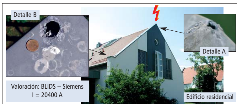
Fig. 5.1.4.2: Ejemplo de daños: cubierta de chapa.
