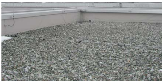
Fig. 5.1.3.2: Instalación captadora sobre tejado plano.
