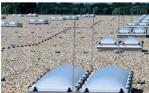
Fig. 5.1.1.19: Tejado plano con puntas captadoras y soportes de conductor: Protección de lucernarios.
