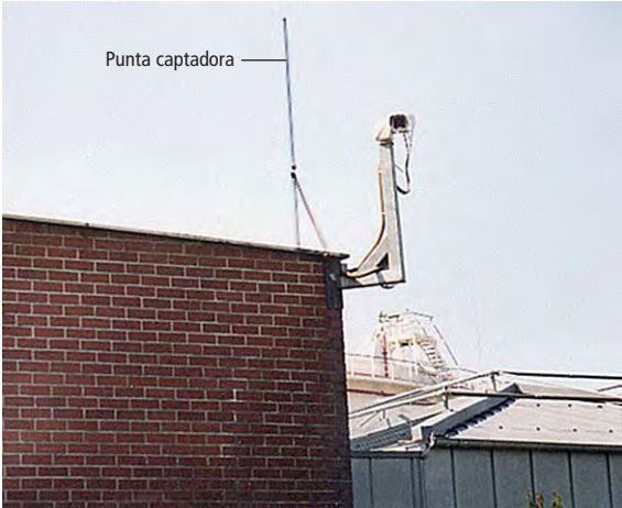
Fig. 9.7.2: Cámara de vigilancia en la zona de protección de una punta captadora.
