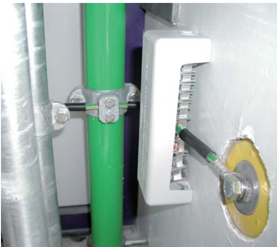
Fig. 7.5.1.1: Conexión de barra equipotencial a un punto fijo de toma de tierra
