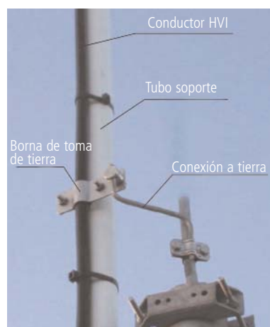
Fig. 5.2.4.2.2b: Conexión al soporte de la antena para control de potencial.
