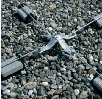
Fig. 5.4.1.1: Instalación captadora. Compensación de dilatación mediante bridas de puenteo.
