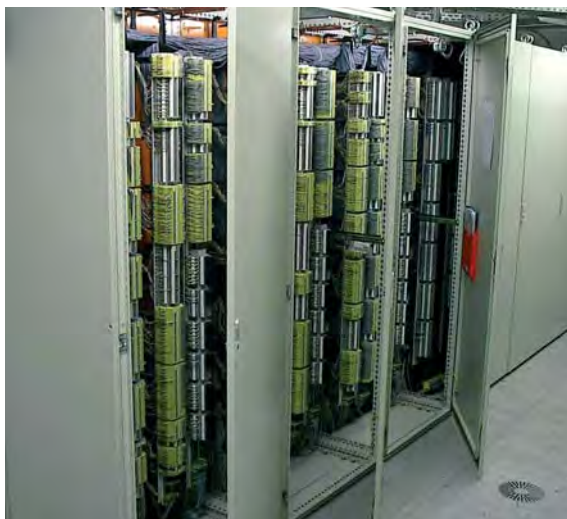
Fig. 9.4.7: Descargadores de sobretensiones DCO ME 24 instalados en cuadro para la completa protección del sistema de medida y control.
