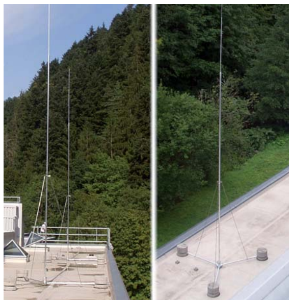
Fig. 5.1.11.1: Protección contra descargas directas de rayo mediante puntas captadoras autosoportadas.
